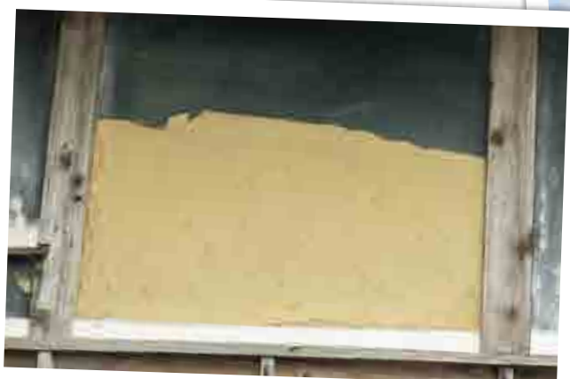
風雨で土壁が剥離
