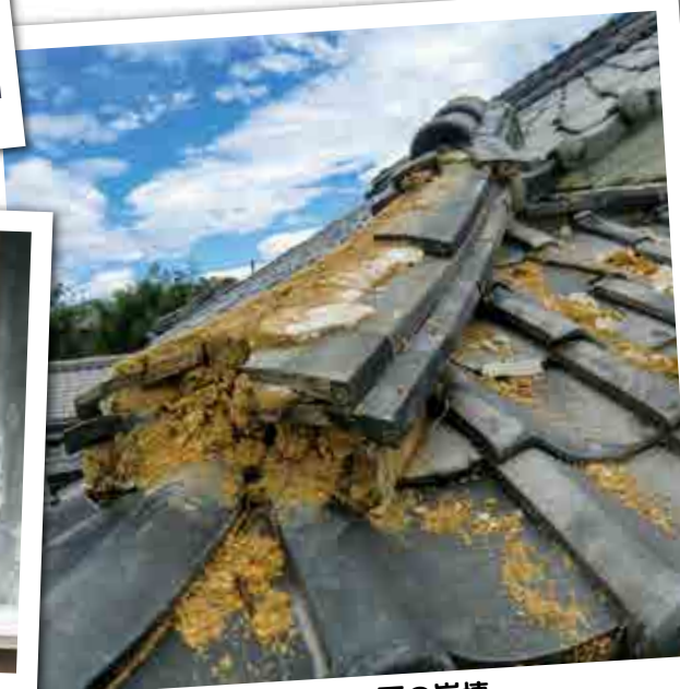
台風でのし瓦の崩壊
