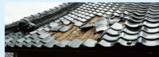
剥がれた屋根の瓦
