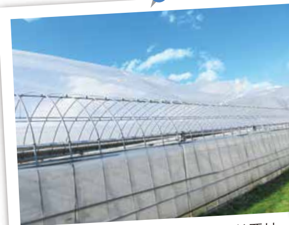
側面から引きちぎるように破れた被覆材
