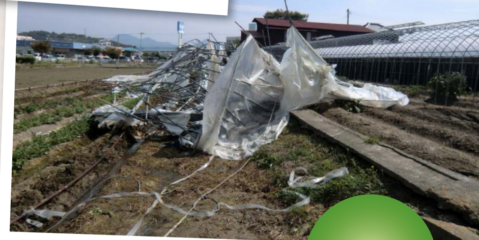
吹き飛んだパイプハウス (丸亀市)
