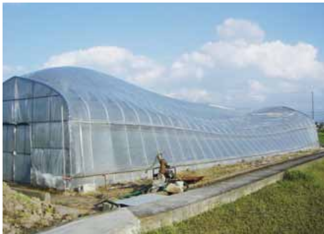
突風で損壊したハウス（善通寺市）
